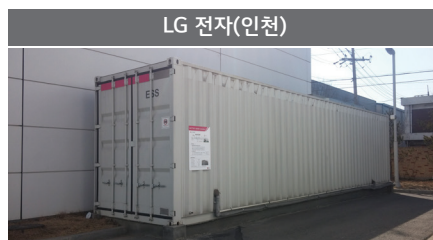
PCS : 4MW / 배터리 : 1MWh 주파수 조정용
