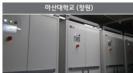
PCS : 1MW / 배터리 : 2MWh 부하 이동용
