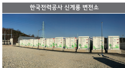
PCS : 24MW / 배터리 : 6MWh 주파수 조정용
