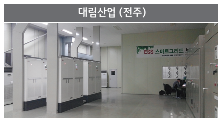
PCS : 1MW / 배터리 : 2MWh 부하 이동용
